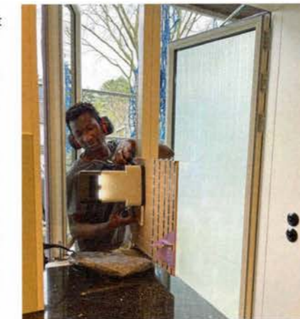
/ Mit der Shaper Origin wurden vor Ort die Fräsungen für die Alarmanlagen-Funksensoren eingefräst.
